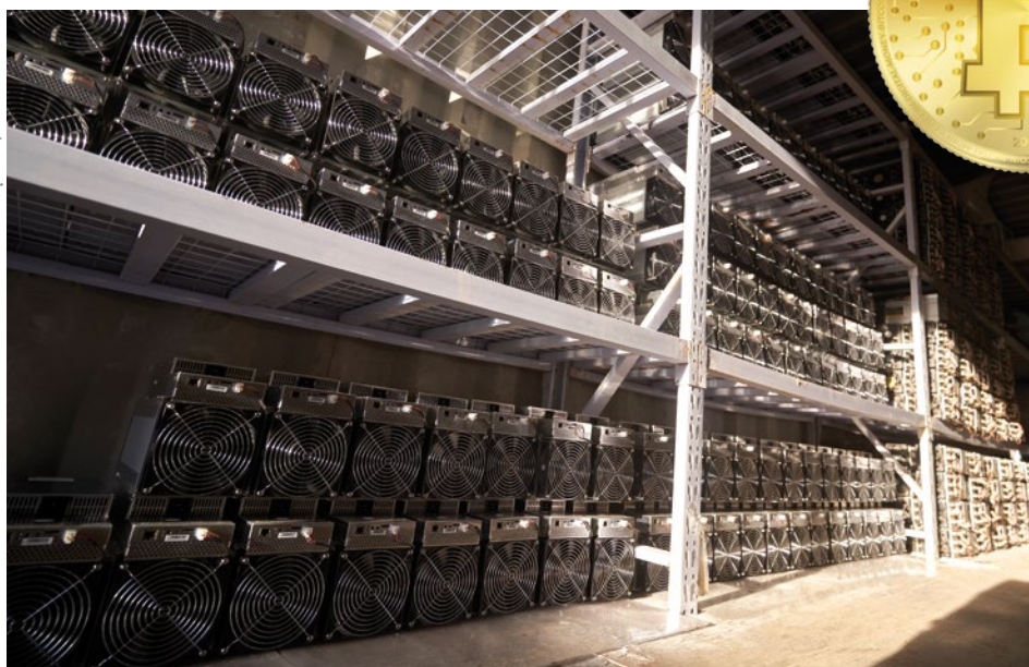
Im Inneren einer Bitcoin Mining-Fabrik. Auffallend sind die vielen großen Lüfter, die für den gewaltigen Stromverbrauch beim Bitcoin-Schürfen mit verantwortlich sind.
