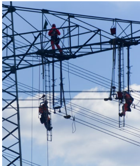
Für den Ausbau der Stromnetze werden Profis gebraucht – und die sind momentan rar!
